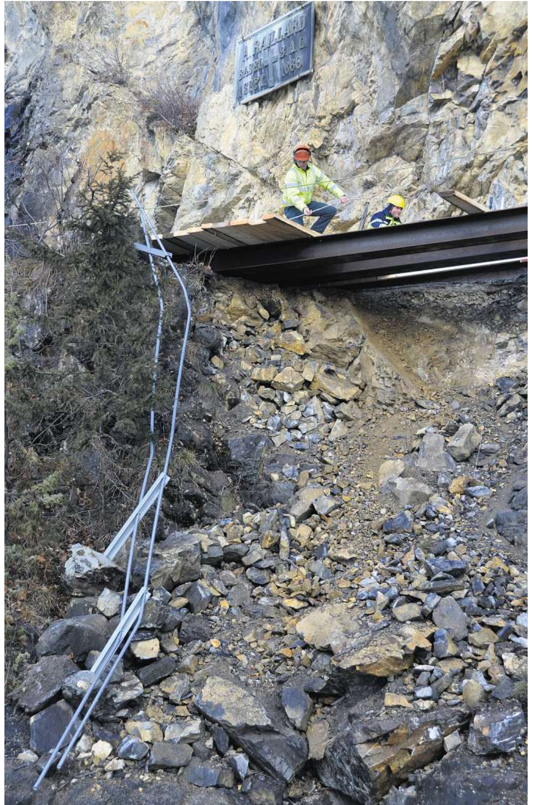
Helfer in der Not: Franz Thoma und Wendelin Böni vom Ammler Werkdienst bauen eine Notbrücke über die knapp zehn Meter lange Einschlagstelle des Steinblocks.
