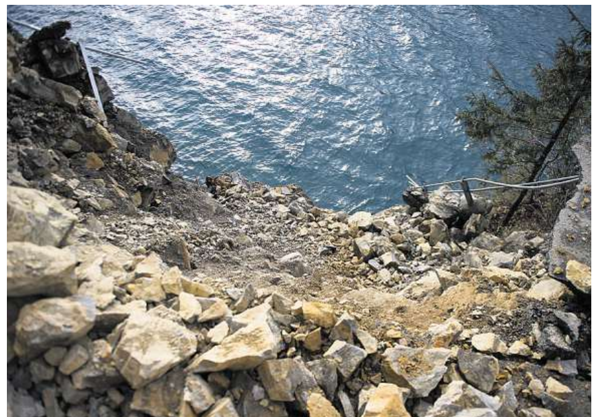
Hier hat der Fels eingeschlagen: Wo früher einmal eine Strasse war, klafft nun ein grosses Loch.
