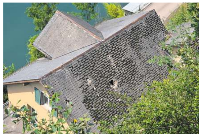
Wichtig: Das Dach des Kraftwerks ist durchgeschlagen.
